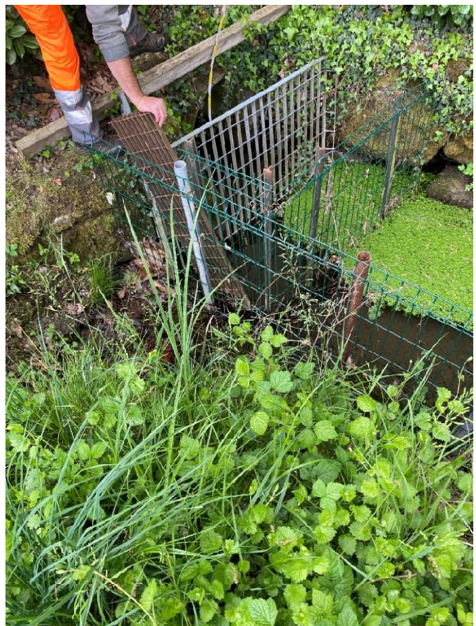
Foto 5.1 – 5.2 – Tratto 5: Vista alveo a monte sottopasso Via Don Corti e imbocco sottopasso (Ø 800 mm)
